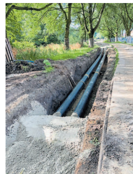
Het dubbele buizenstelsel.
